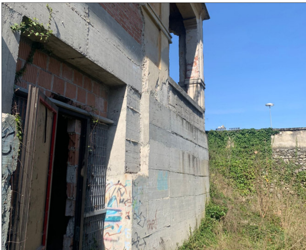
Figura 10: angolo nord-est dell’edificio (si noti l’abbassamento del terreno perimetrale rispetto alla quota di calpestio originaria dell’ingresso in angolo)
