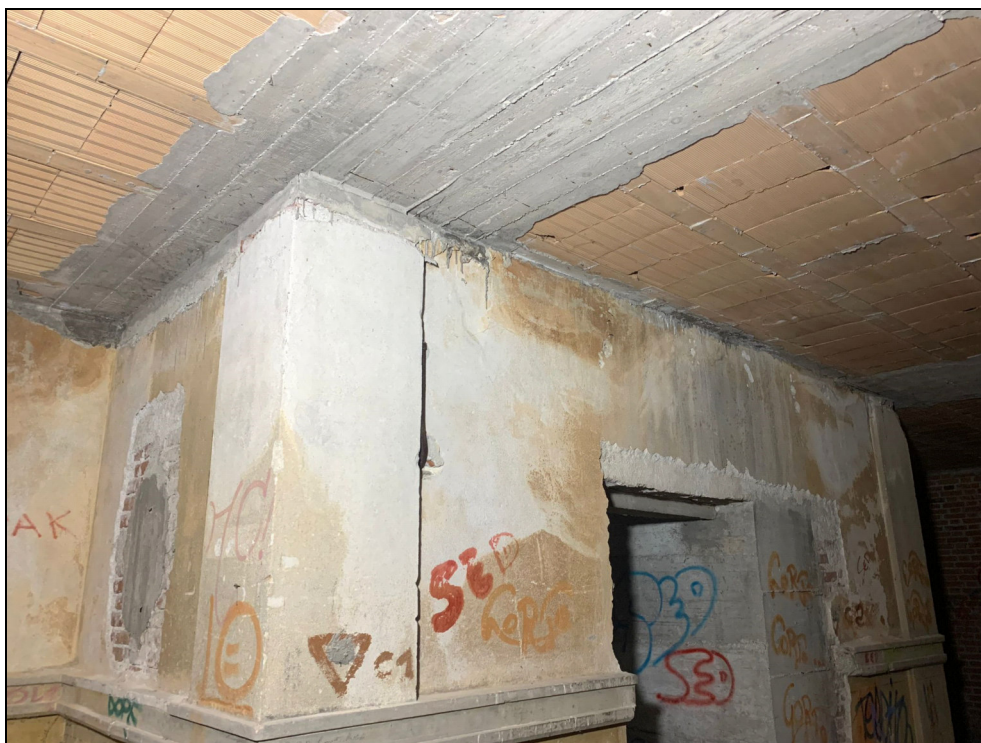
Figura 12: primo piano della superfetazione sul lato ovest (si noti l'assenza del giunto sismico fra i muri originari del vano scala retrostante di Villa Toppani e la nuova superfetazione)
